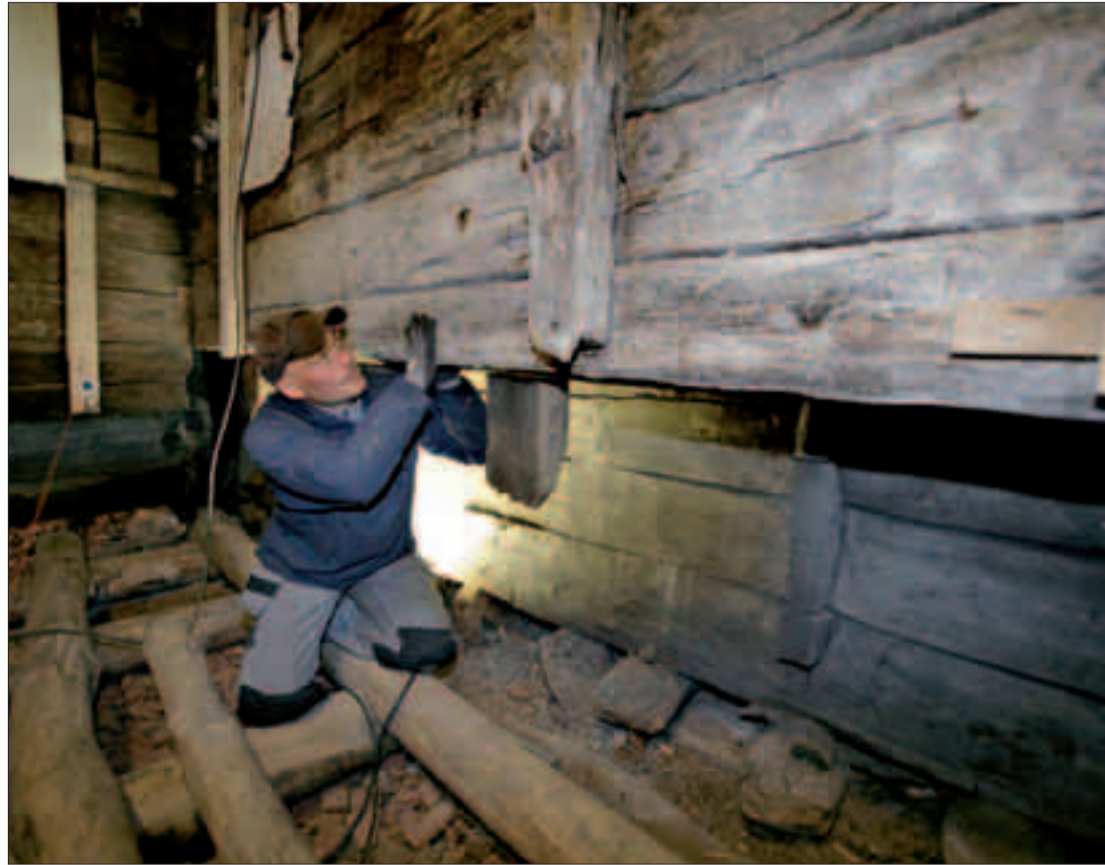
KRITISK: Bryggen i Bergen er utsatt for havstigningen. På bildet ser vi tømrer Bjarte Guldbrandsen jekke opp en del av Holmedalsgården en halv meter for å lage nytt fundament (oktober i fjor).
